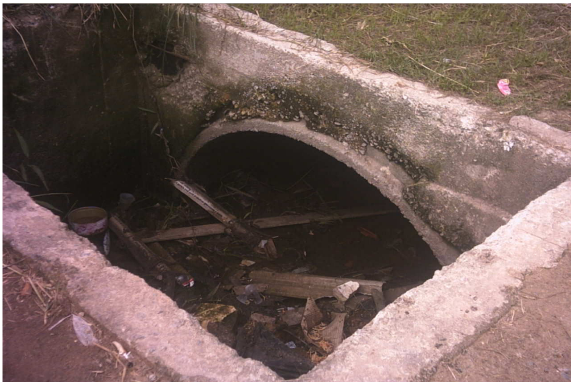
Figura 6: Assoreamento no Canal do Anhaia.
